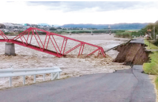
崩落した別所線の鉄橋〔千曲川左岸から〕
